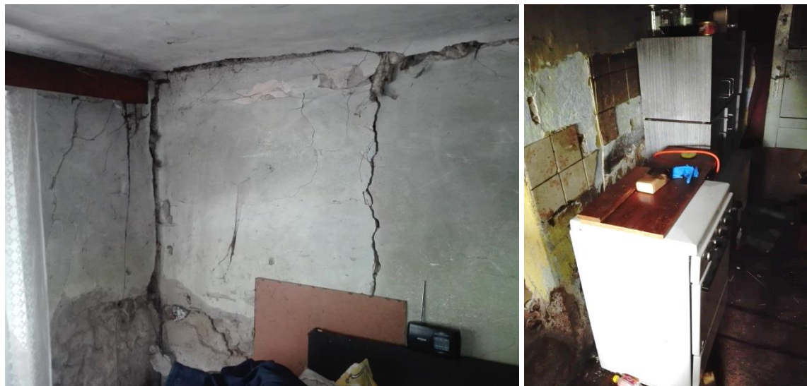
Kuchyňská linka prakticky chybí, pouze stojící plynový sporák. Technický stav budovy je velmi špatný.
