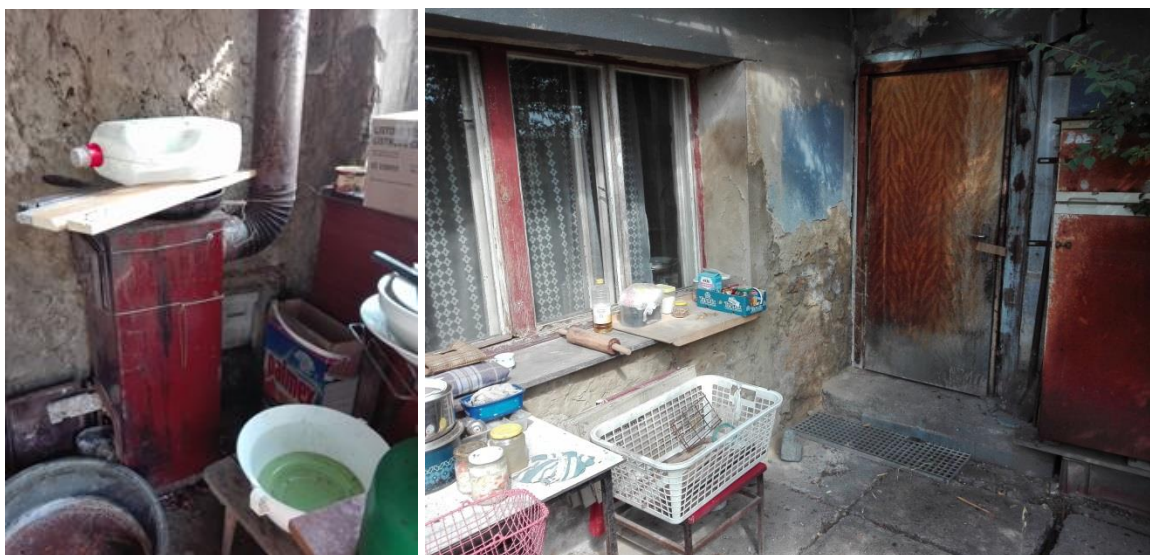
Vytápění ústřední na tuhá paliva je nefunkční
