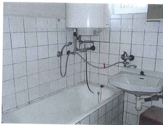
Detail koupelny s boilerem na TUV
