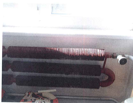
Nevhodné topné těleso pro parní vytápění použité pro teplovodní rozvod
