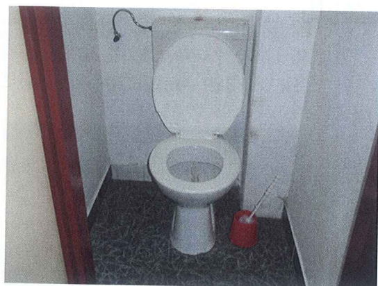
Splachování WC bez keramického obkladu stěn
