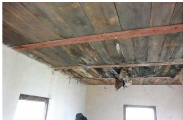
Sklad 2 – poškozená střešní + stropní konstrukce
