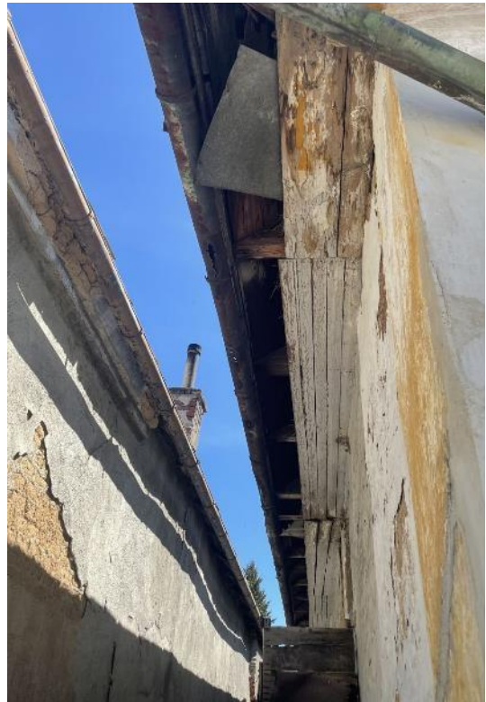
poškození u rodinného domu
