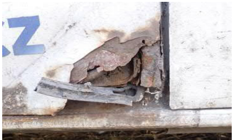
pravé boční dveře a pravý práh zkorodovány
