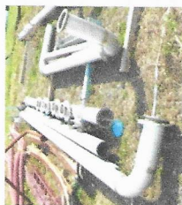
Obr. č. 3. Nerez potrubí + příruby
