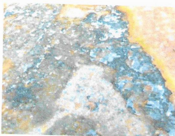
Obr. č. 5. Pohled na ložisko totálně zkorodovaného plechu na dno nádrže
