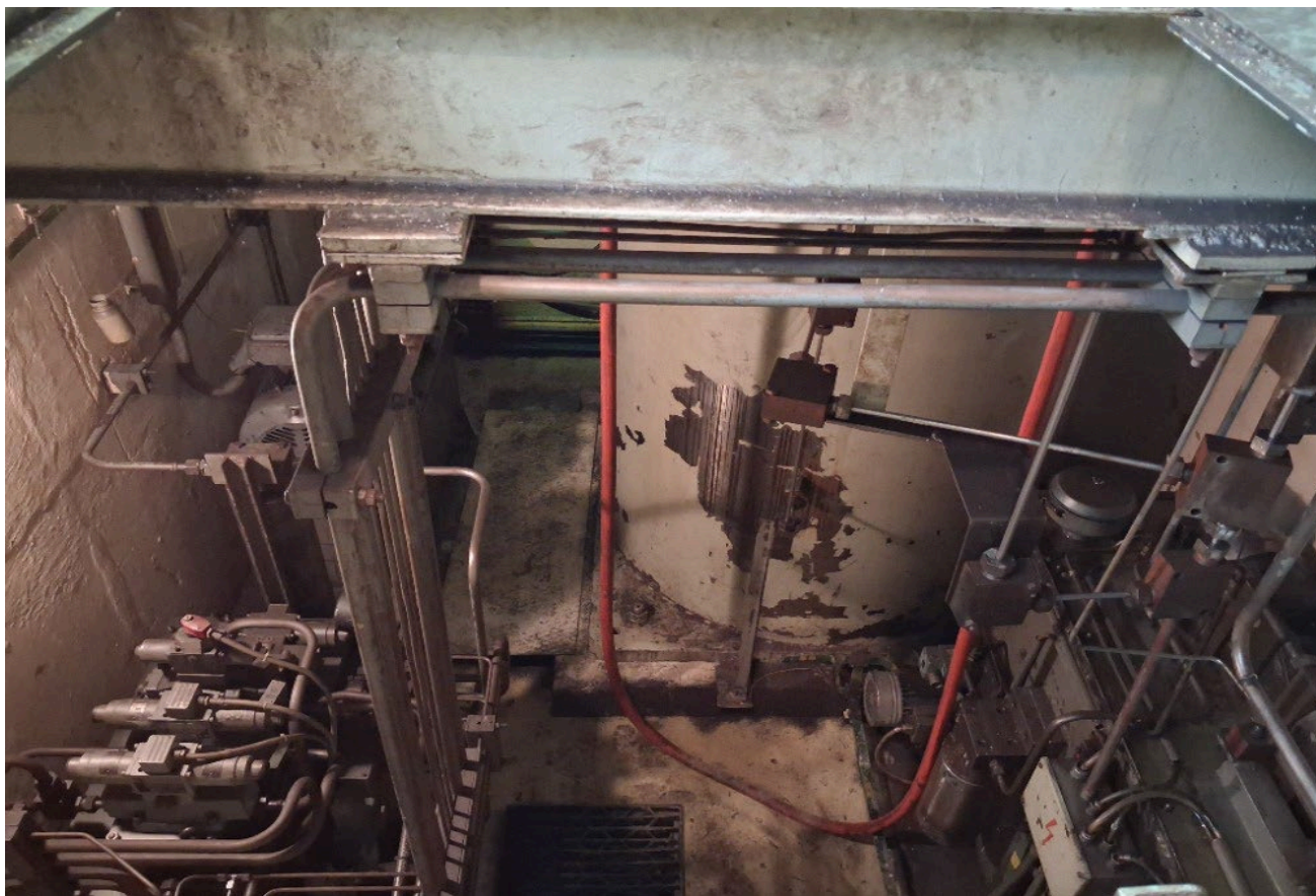
isostatický lis (strojovna v -1 podlaží)
